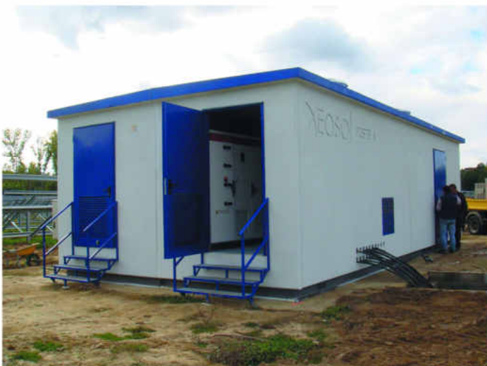
Casetas parques solares promotor
