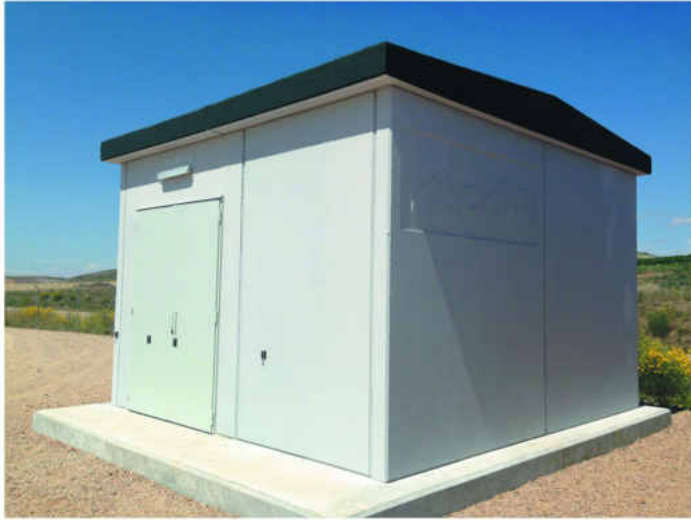
Caseta grupo electrógeno ADIF
