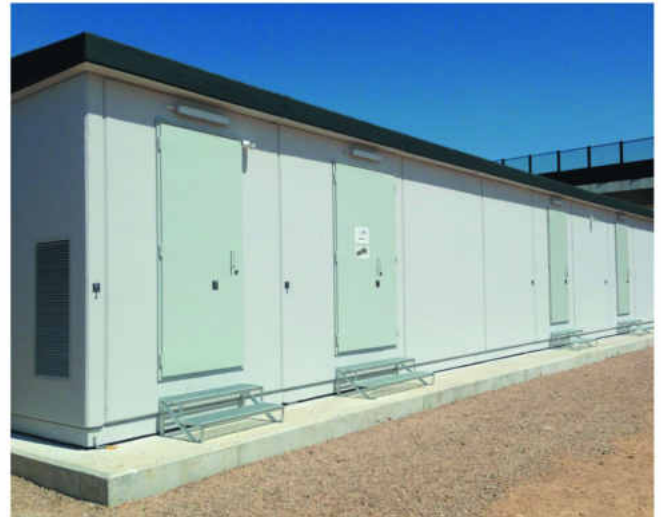
Caseta para señalización
