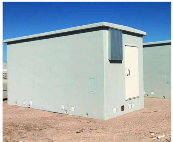
Casetas Tipo CT
