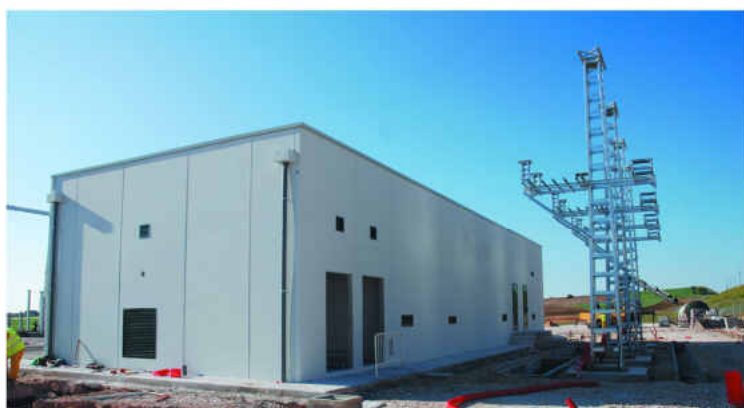
Centro de transformación
